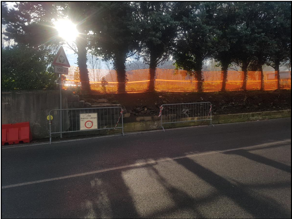
Foto 6 – Via Fratelli Kennedy porzione di muratura in blocchi crollata adiacente a muro in cls esistente
