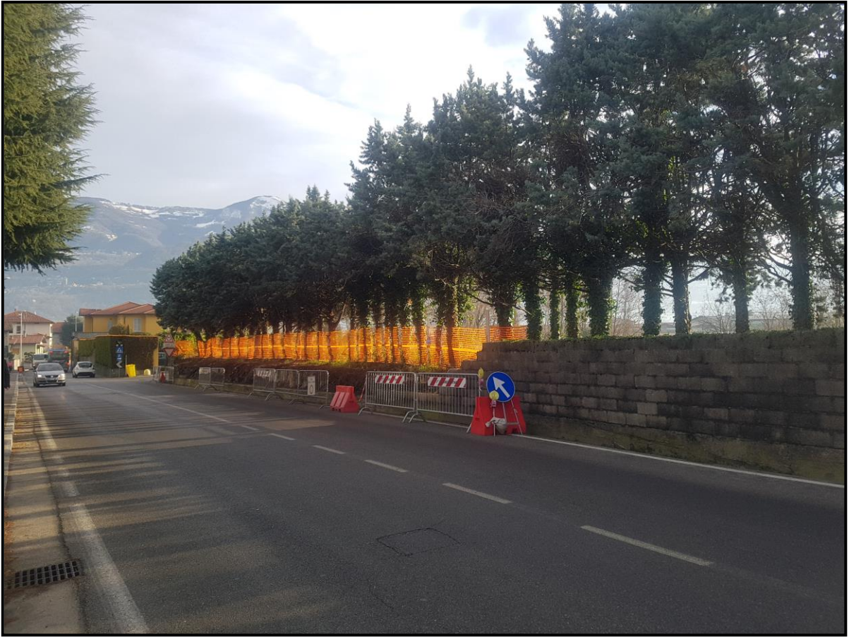
Foto 3 – Via Fratelli Kennedy tratto interessato dal crollo del muro in blocchi
