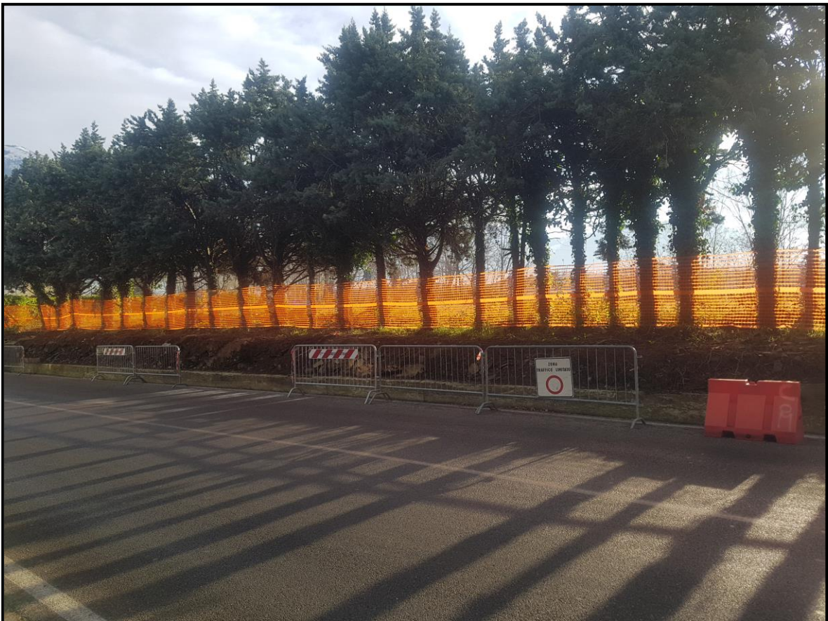
Foto 4 – Via fratelli Kennedy crollo completo della muratura in blocchi
